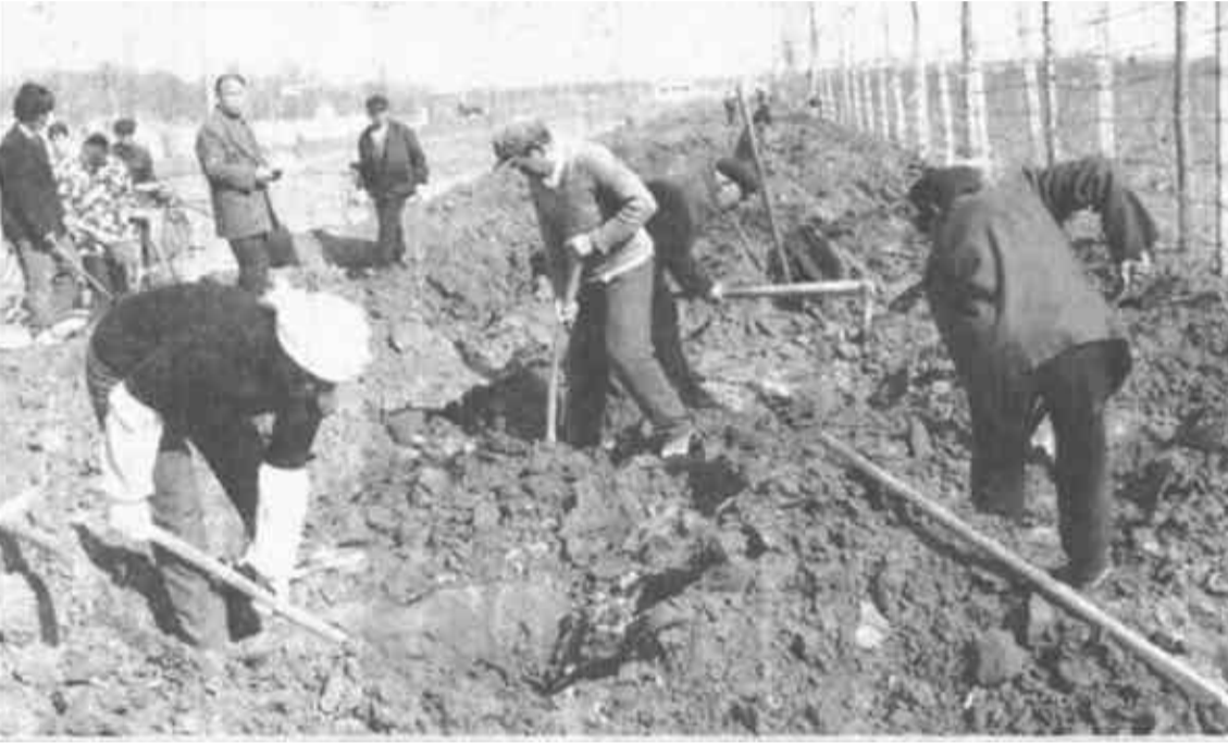
广饶县大王镇十分重视搞好城镇绿化。今春，该镇计划城镇道路绿化植树20万株，所有道路全部实现林带配套。目前，20万株植树任务全部落实到人，农民们正积极投入挖坑备植。（徐兆鹏 摄）
